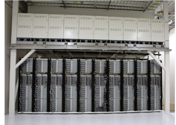
Instalación de Microsoft alimentada por pila de combustible
