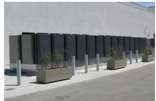
Sistema de pila de combustible de CenturyLink
